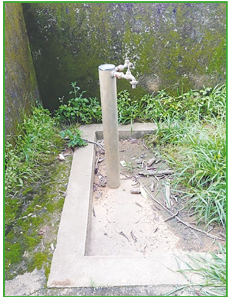
Photo 8 : Réseau d'adduction potable réhabilité par CAL et non fonctionnel
